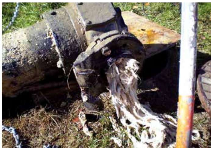
Fäkalpumpe voller Feuchttücher.
