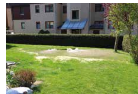
Unverzögliche Reparatur bei Rohrbrüchen.
