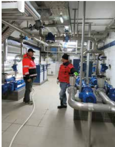
Auch im Kellergeschoss der Kläranlage befindet sich modernste Kanaltechnik.
