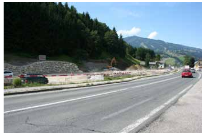
Um auf den Fastenberg zu kommen, muss man bald nicht mehr auf die Bundesstraße, sondern kann auf direktem Weg aus der Stadt sein Ziel erreichen. Die Arbeiten dafür schreiten zügig voran.
