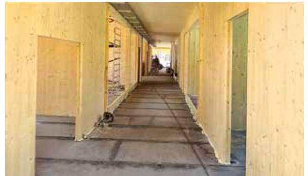
Bild rechts: Große Spielstraße für die Bewegung der Kinder auch bei Schlechtwetter.
